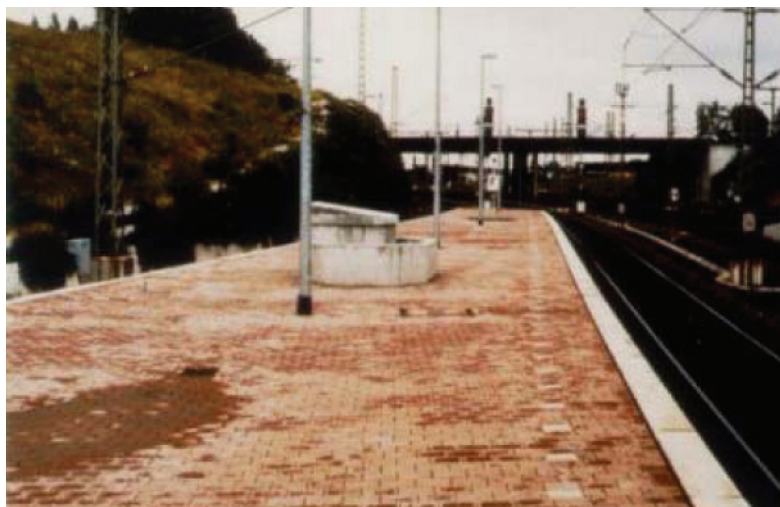
Figura 1 mostra a plataforma de uma estação ferroviária com pavers de concreto vermelhos, sobre o qual foi formada eflorescência pesada.
