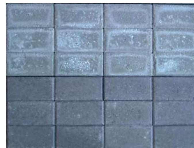
Eflorescência primária Eflorescencia primaria
